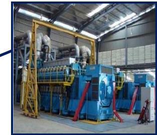
PHNOM PENH THERMAL POWER
