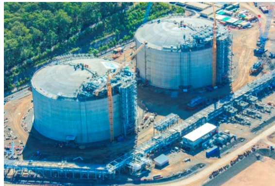
Curtis Island LNG tanks
