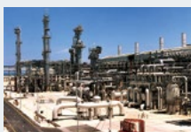
LNG project (Qatar)
