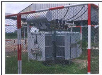
TRANSFORMER 1,500 KVA (01-PM-0137)
