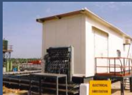
Switchgear Room – ONGC, Tatipaka
