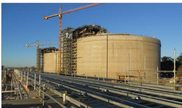
LNG Tanks, August 2014
