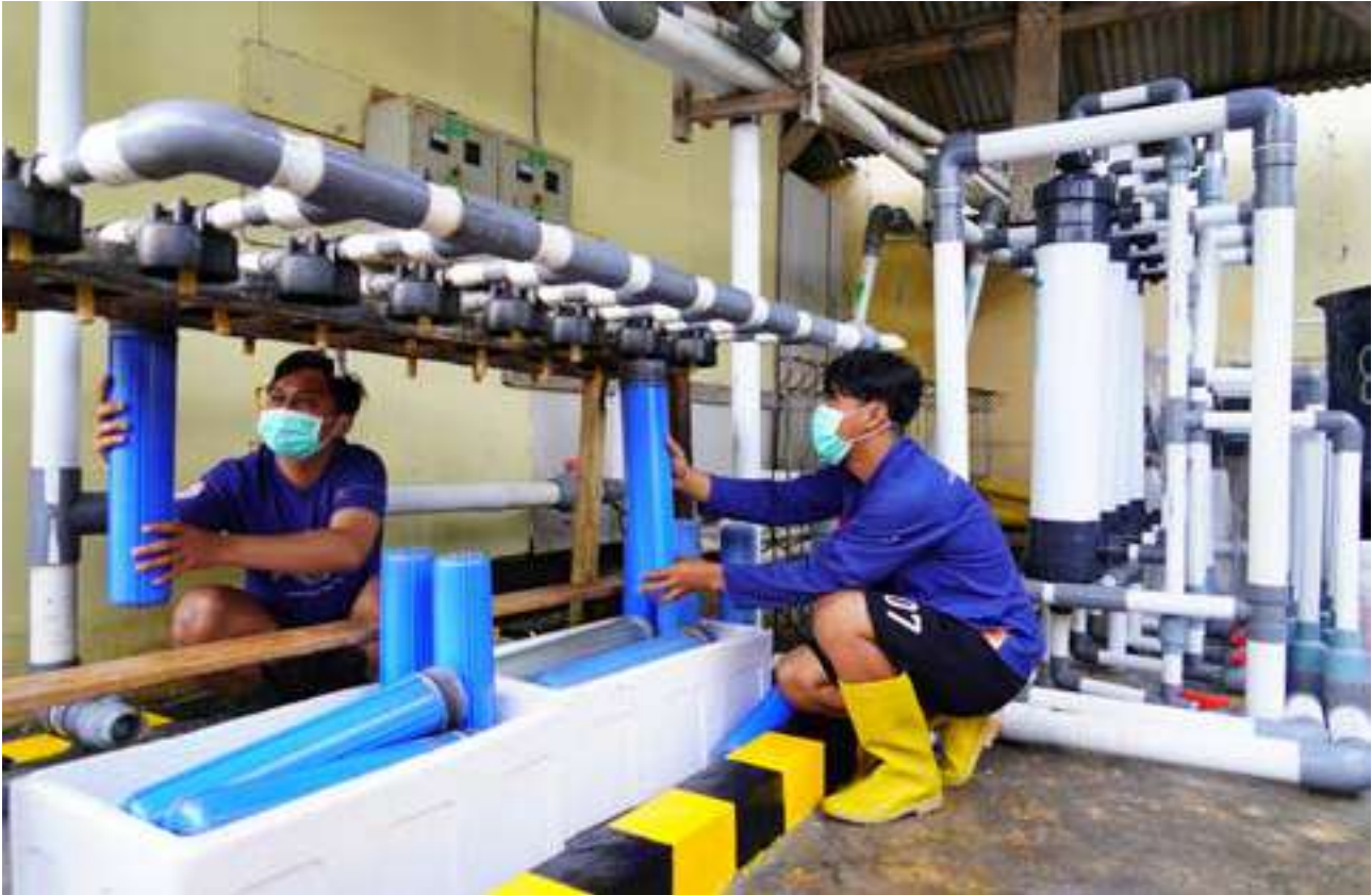
Fasilitas Daur Ulang Air Ketapang Wastewater Treatment Ketapang
