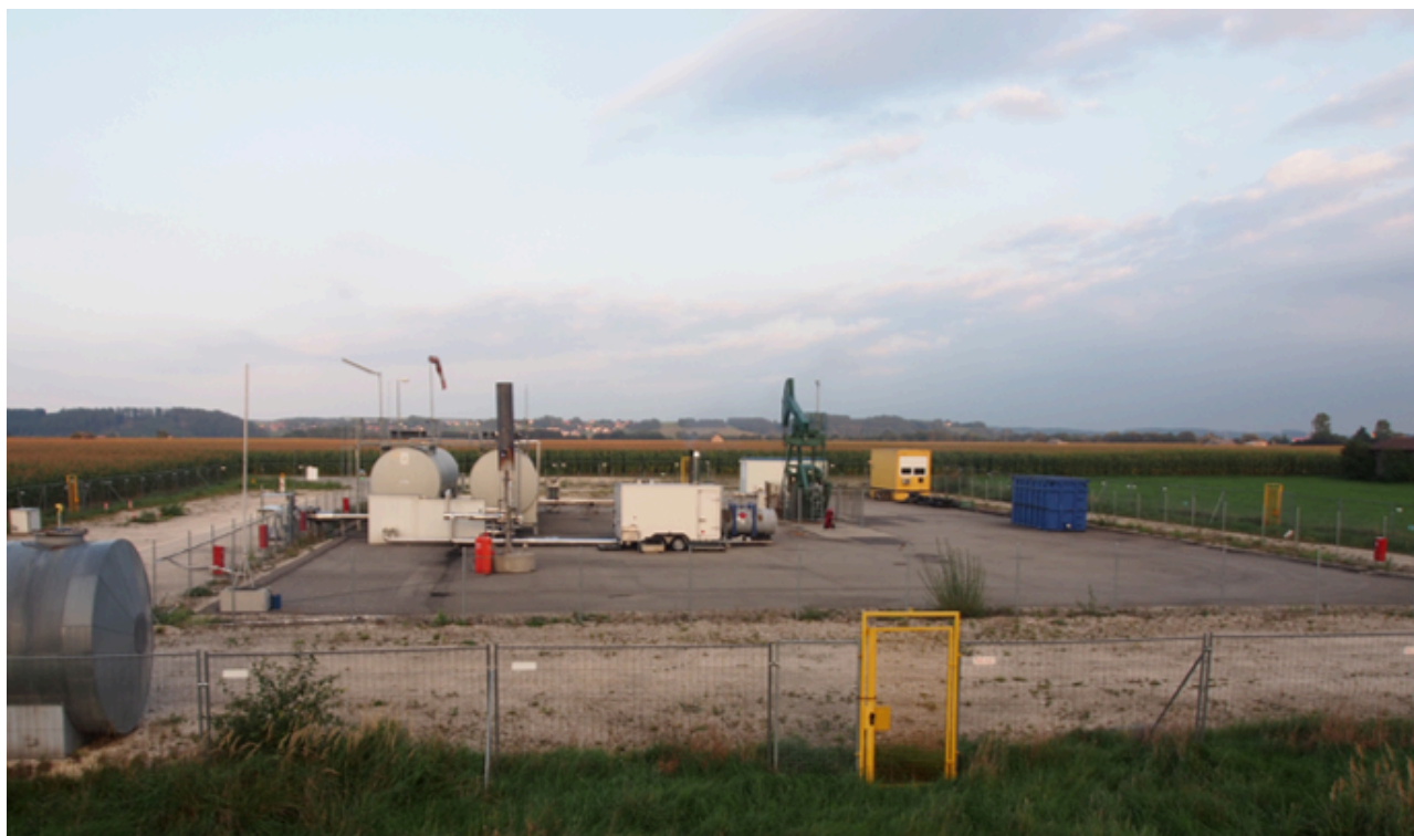
Fig. 4.7 Lauben production site
