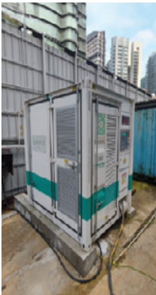
▲ Enertainer on construction site
