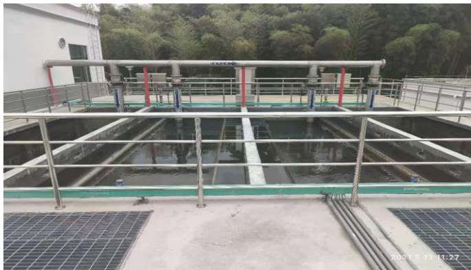
圖 4 江西宜黃工業園區污水處理廠項目反硝化深床濾池
